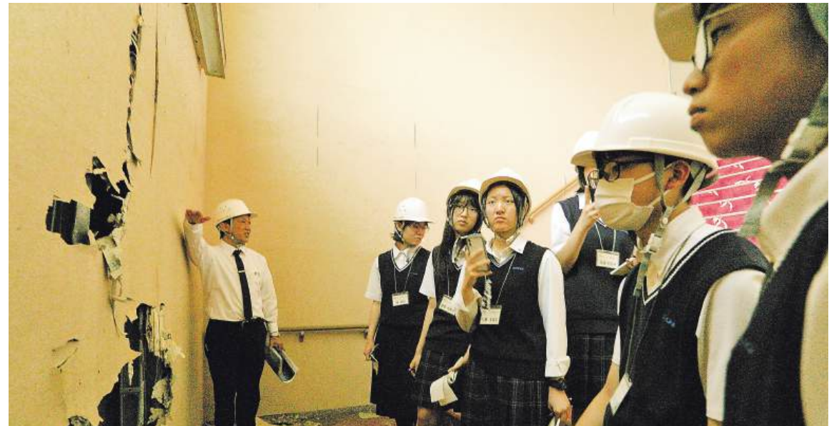
高野会館の屋上への階段室に残った津波の痕跡を確認する生徒たち
