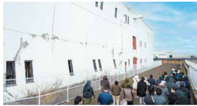
津波の威力で壁面が大きくへこんだ第3ポンプ場
